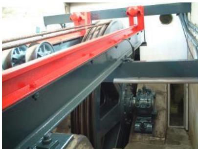
従索輪、直径3.4m 主索輪との間でロープを8の字に掛け 滑らないようにしています。
