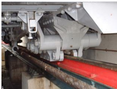
車両側の制動装置 万が一、ロープに異常が発生した場合 等に、レールを挟んで車両を止めます。
